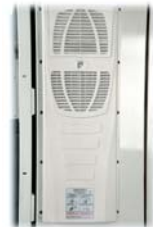
Sistema de climatização do armário elétrico
