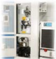
Sistema de refrigeração do painel
