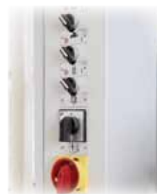
Painel de Comando
