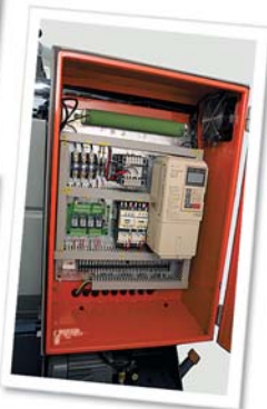
Painel elétrico com inversor de frequência de velocidade
