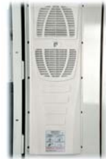
Sistema de climatização do armário elétrico
